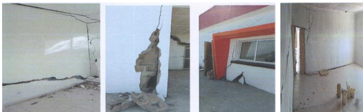
Figure 5: Tassement différentiel de la MCC de Morondava avant effondrement
