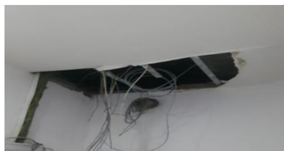
Figure 3: Plafond arraché HAVORIA
