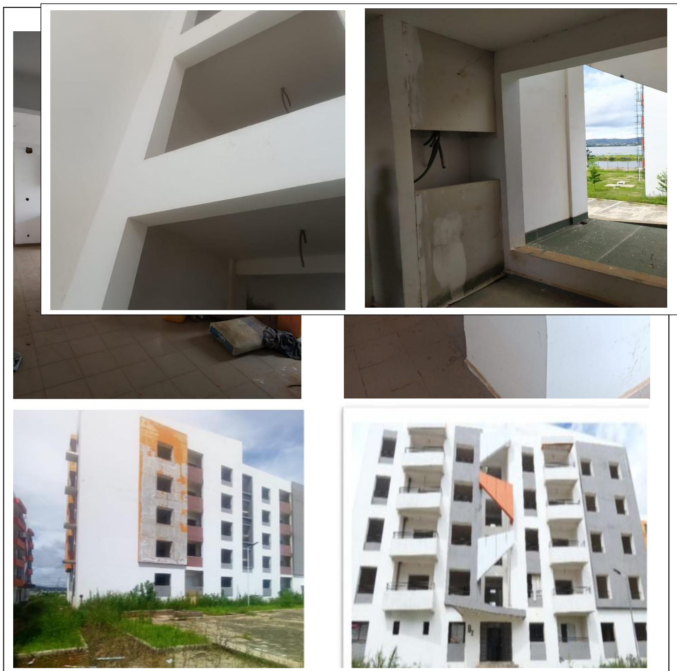
Photo 4 : illustrations des travaux non réalisés
