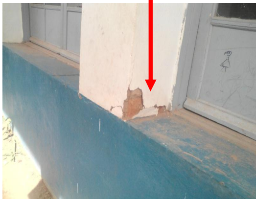
Fissures aux bords des fenêtres du rez-de-chaussé
