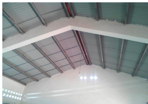
Absence de plafond en volige de pin : EPP Anganomasina, Ivandry, AntanjombeAmbony, et Ambohitrinandriana
