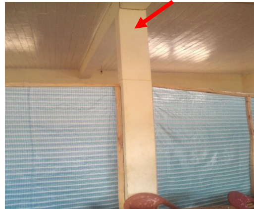
Fissures au niveau de la jointure entre la poutre et le seul poteau de support au rez- de chaussez
