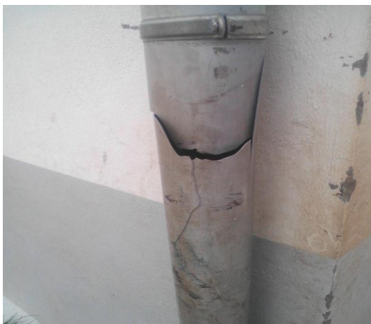
Gouttière de mauvaise qualité : Cas de l'EPP Anosibe
