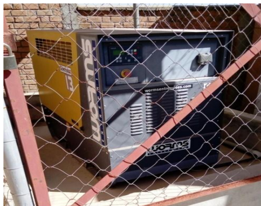
Groupe électrogène en panne du site d'Ambohimailala
